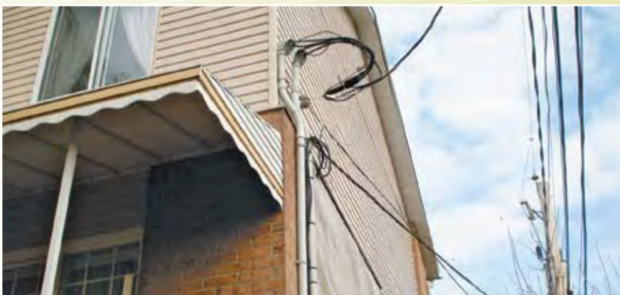
L'entrée électrique qui dessert quatre logements polluait grandement le bureau et la chambre de Sharon Déoux. Ses sérieux problèmes de santé ont disparu après la pose de moustiquaires au mur et au grenier pour bloquer les champs électriques et le rapprochement des conducteurs les uns des autres par Hydro-Québec afin d'atténuer les champs magnétiques. © essentia.ca
